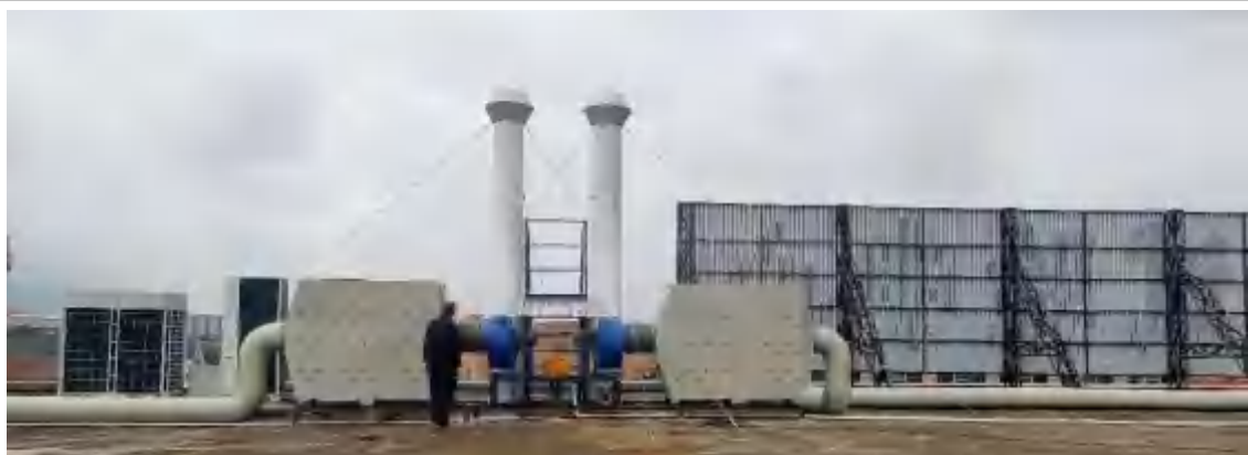
废气处理装置及排气筒（左）
